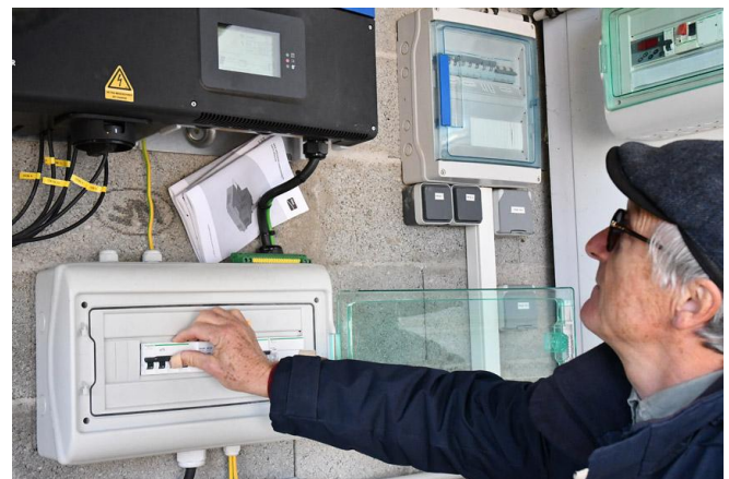
+ Mise en service de notre deuxième installation PV à la ferme de La Josière.
